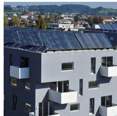
Flat plate solar thermal collectors installed on the roof - Stadtwerk Lehen, Salzburg (Austria) Photo: Fotohof Phelbs
